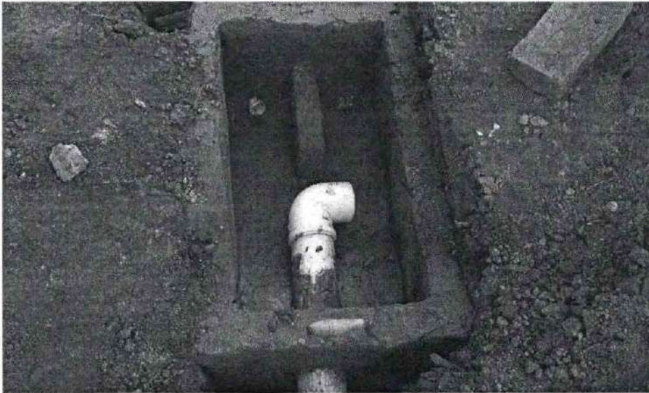
Valas de infiltração e evapotranspiração com bananeiras e biris, construídas em duplicidade e detalhe do mecanismo de alternância da vala.
